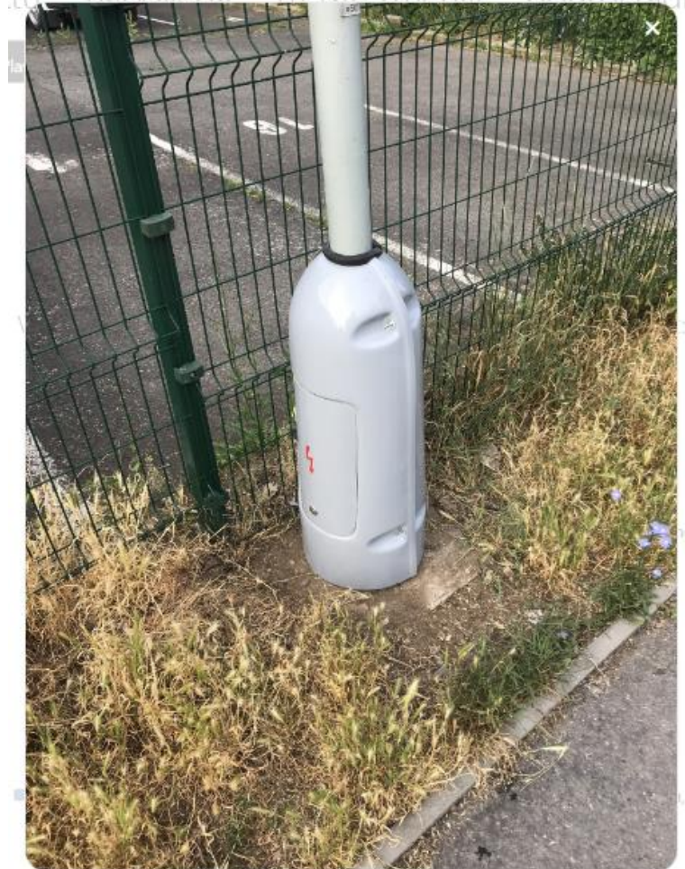
■ Oprava krytu veřejného osvětlení na ulici Na Pláni, Praha 5. Podnět ze dne 19.05.2018
