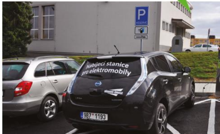
Dobíjecí stanice v Pelhřimově
